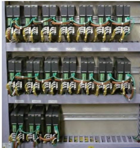
図2 盤内に設置されたテレメータD3シリーズ
