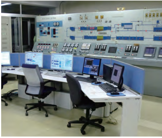
図1 腰越浄水場中央監視室
