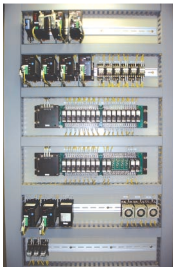
図6 盤内に設置されたテレメータ装置
