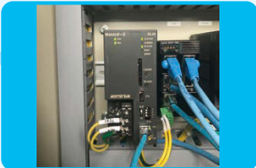
事務所に設置したWebロガー2
