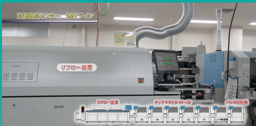
エム・システム技研 京都商品センター SMTラインのリフロー装置
