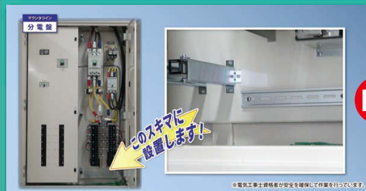
SMTラインの配電盤
