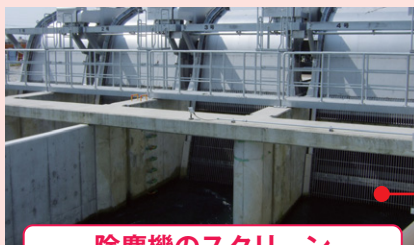
除塵機のスクリーン
