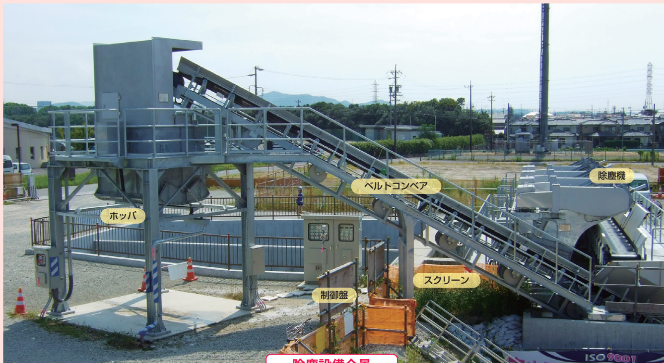
除塵設備全景
