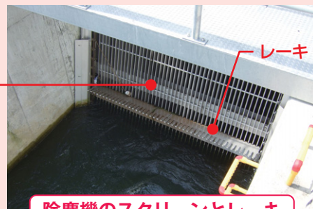
除塵機のスクリーンとレーキ
