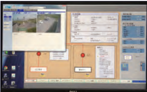
図3 陸上連系設備電気設備内の監視パソコン
