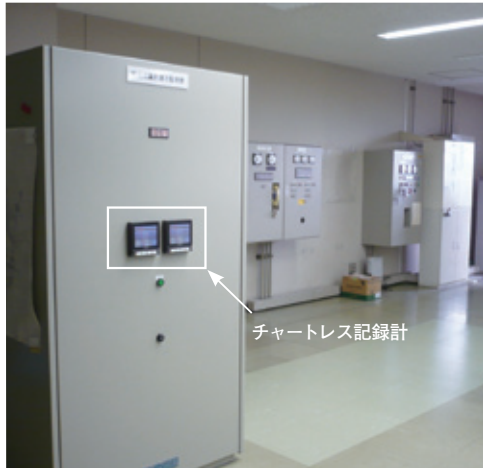
図2 監視盤に設置されたチャートレス記録計
