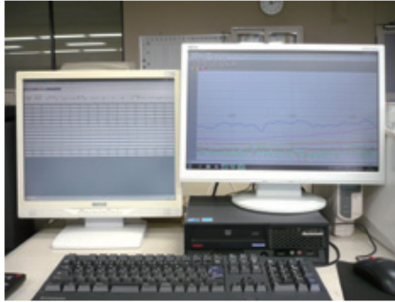
図3 監視用パソコン
