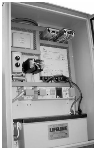
図6 回転灯設備操作盤内
