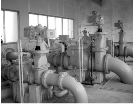
図3 揚水機場ポンプ
