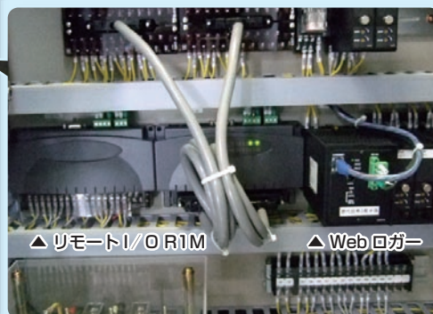
図4 計装盤とその盤内
